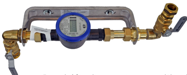
Exempel på fjärravläst vattenmätare monterad i konsol
