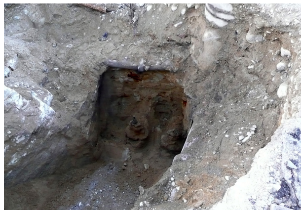
Ibland är det trångt att komma åt ledningarna. Här var det berg på ena sidan och dagvattenledningar på de andra sidorna.
